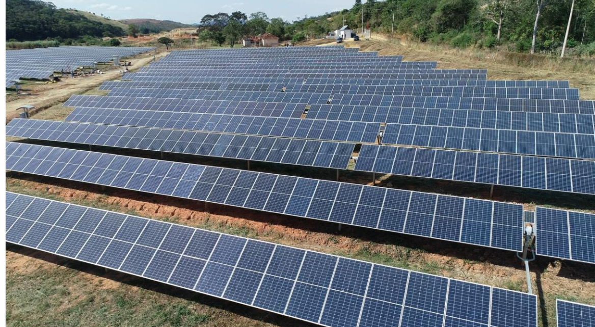
Usina fotovoltaica da Yduqs, em Três Rios, estado do Rio de Janeiro.
